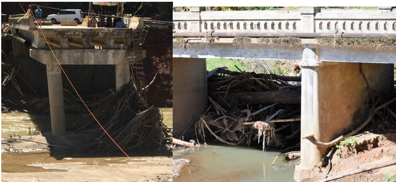
(Lat: +18.301439°, Lon: -66.698319°, 11/02/17) a) PR-123 bridge failure (“Los Olvidados”)
